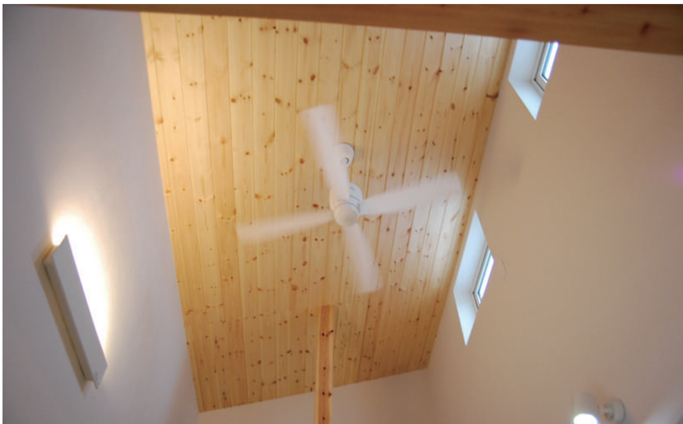
レッドパイン パネリング
